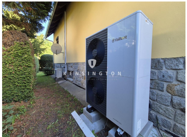
Wärmepumpe und Klimaaggregat
